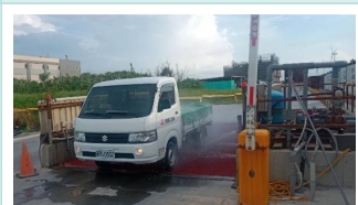
出入口設置洗車設備
